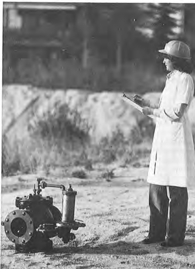
Vista de una válvula de altitud de gran precisión. Obsérvese el tamaño del mecanismo detector de la presión de agua en el depósito.
