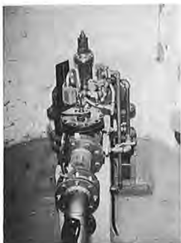
Obsérvese el reducido espacio de la instalación para eliminar el golpe de ariete.
