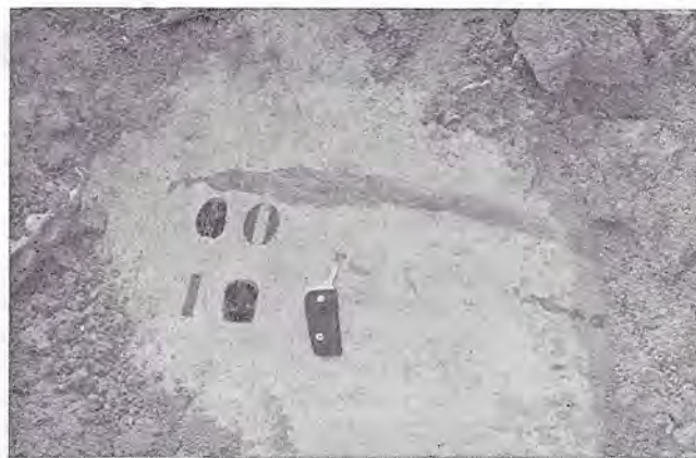
Corrosión del acero de la armadura en espiral de un tubo de hormigón armado.
