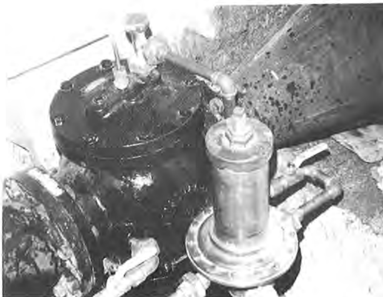
Válvula de altitud de gran precisión instalada a la entrada de un depósito.
