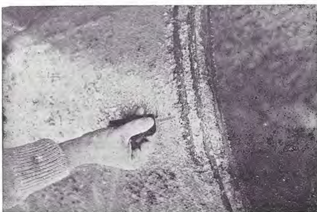
Corrosión de la armadura en la junta de un tubo de hormigón.
