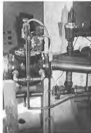
Vista lateral mostrando a la izquierda la válvula de retención controlada y arriba a la derecha la válvula de alivio estabilizada.
