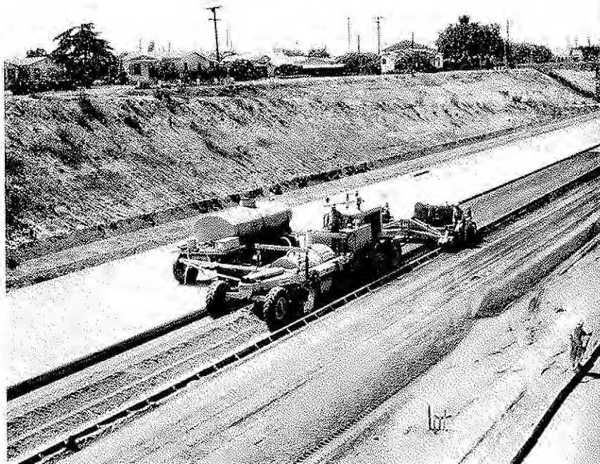
Mezcladora de suelos acoplada al vientre de una motoniveladora, con una extendidora y compactadora especial acoplados.
