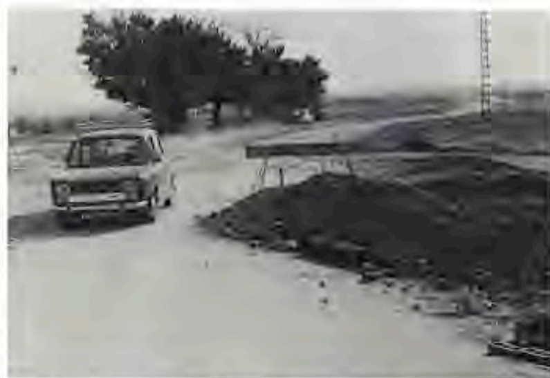
La señalización de las obras hay que hacerla pensando en la seguridad.
